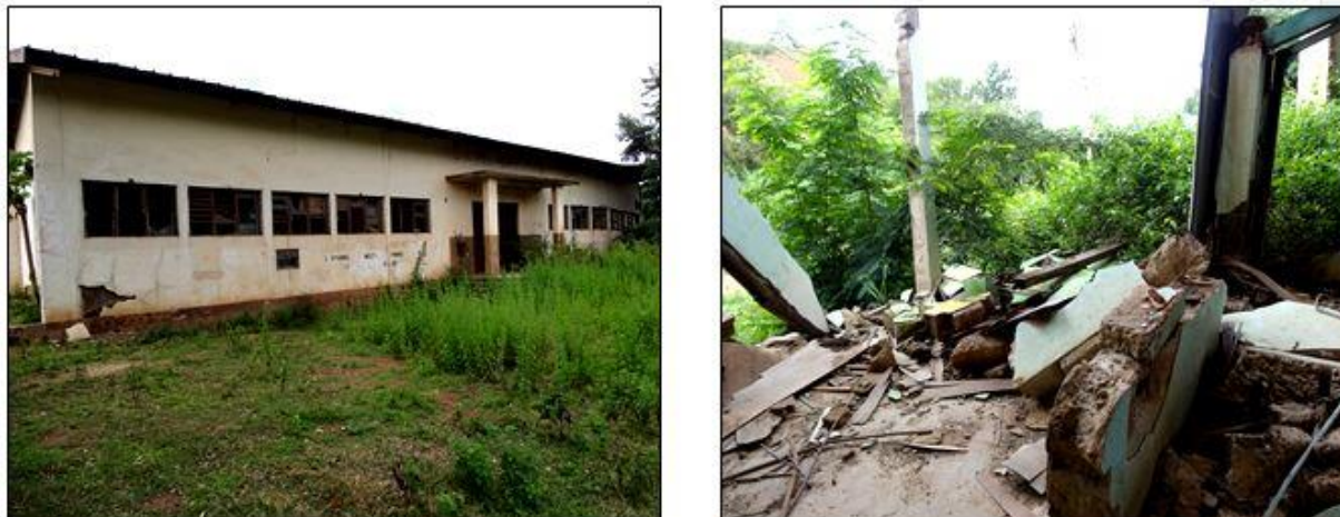
Figure 10 : Bâtiment de l'ancienne Sous-préfecture de Tortiya, effondré sous l'effet des galeries souterraines Crédit : M.Yoboué/GRPIE
