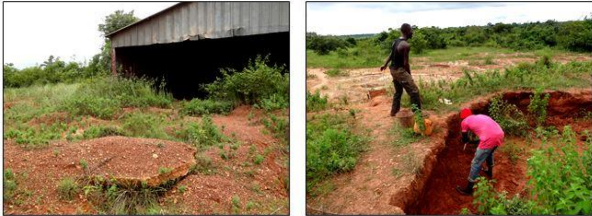
Figure 9 : Le hangar de l'aérodrome détruit et des exploitants clandestins qui creusent sur la piste d'atterrissage Crédit : M.Yoboué/GRPIE
